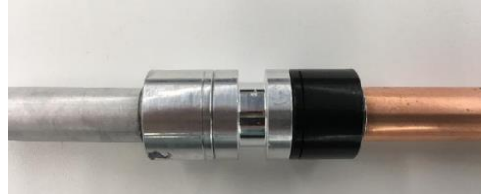
配管接続状況
