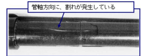
樹脂管の溶剤亀裂(ソルベントクラック)
