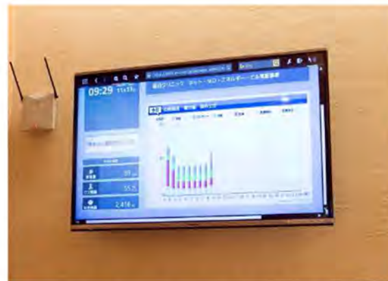
待合室での使用状況の表示 エネルギーの見える化
