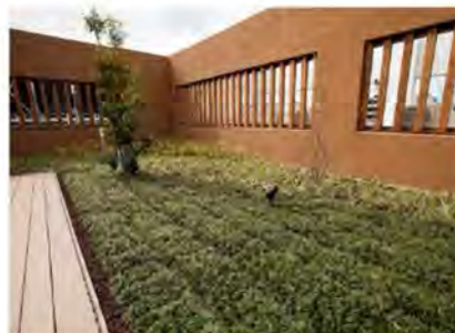
屋上緑化散水
