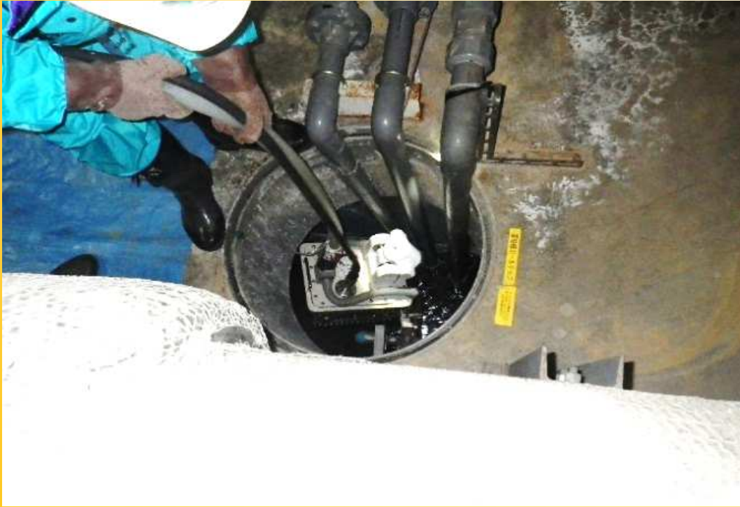
ロボットを蓄熱槽へ
